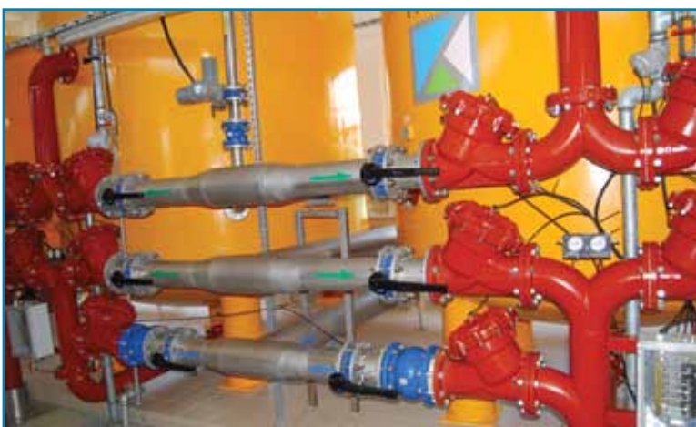
Stacja uzdatniania wody
